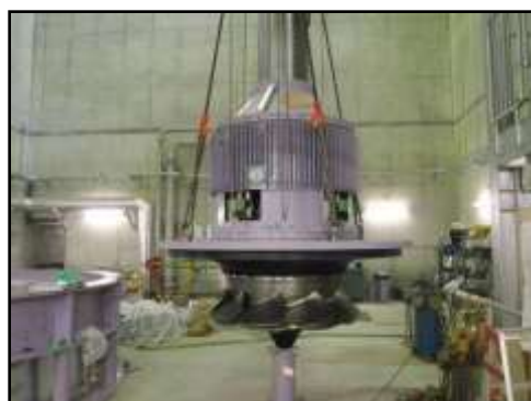
写真 2 新野川第一水車ランナ
