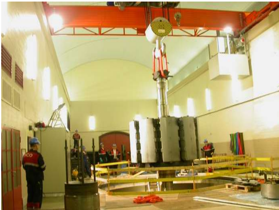
Hemsil 2 号 発電機がある発電所建屋
