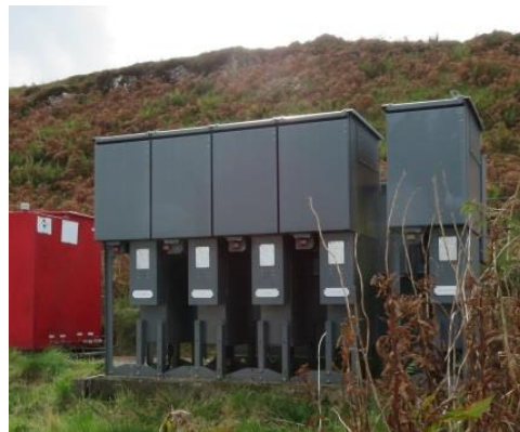
写真-3 屋外配開装置
