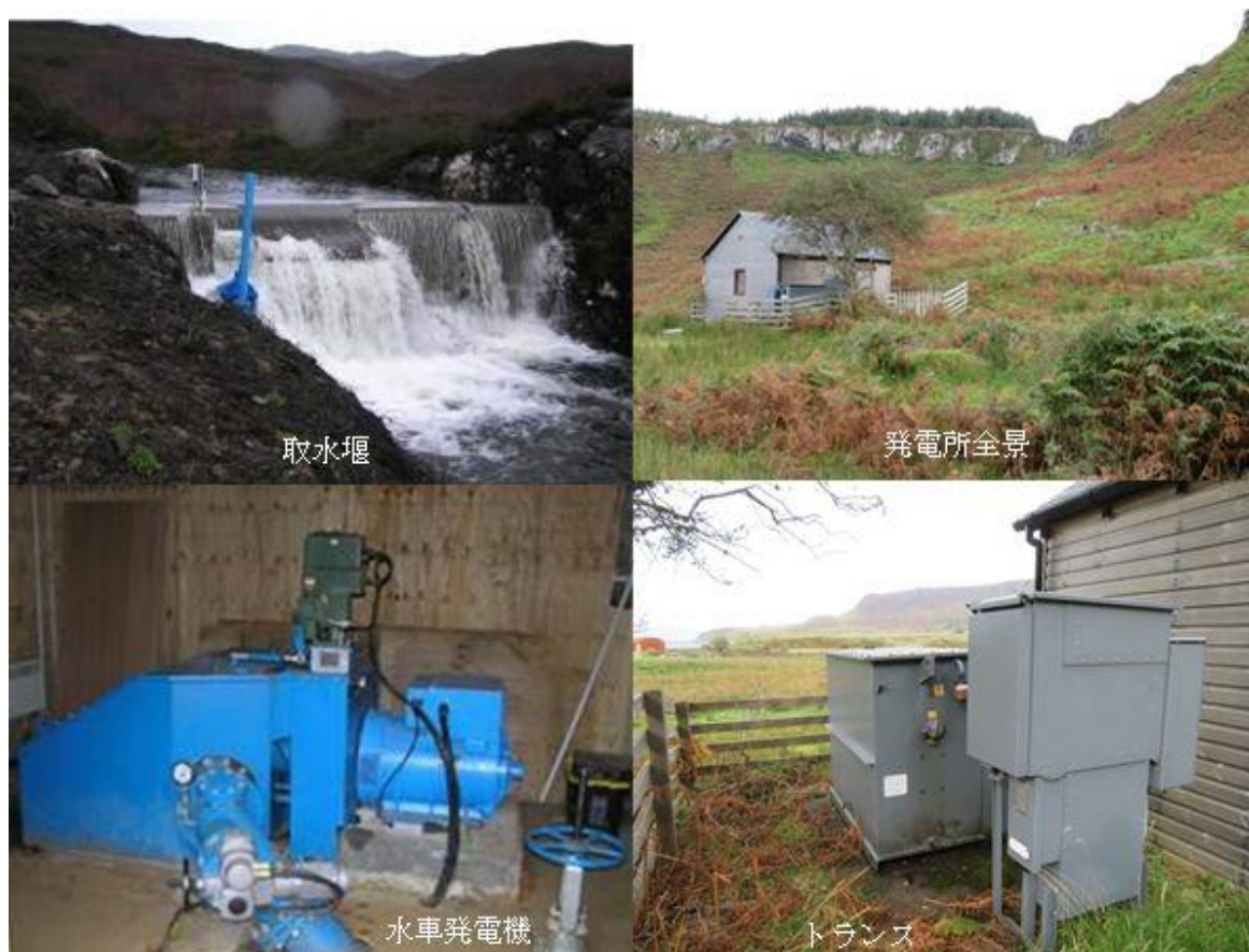
写真- 4 Laig farm 発電所
