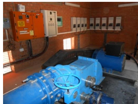
写真-2 水車・発電機
