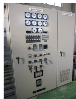
写真-8 発電機制御盤
