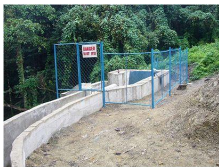
写真-4 ヘッドタンク
