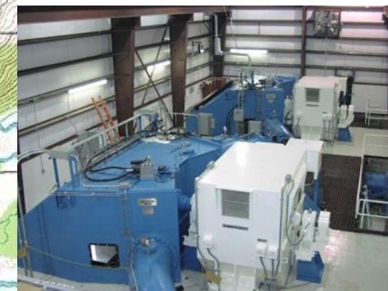
Power Creek 発電所内の 水車発電機
