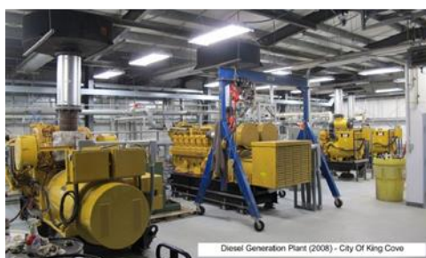
写真-2 ディーゼル発電所 [3]
