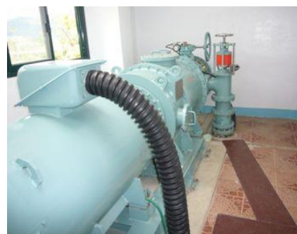
写真-7 水車・発電機
