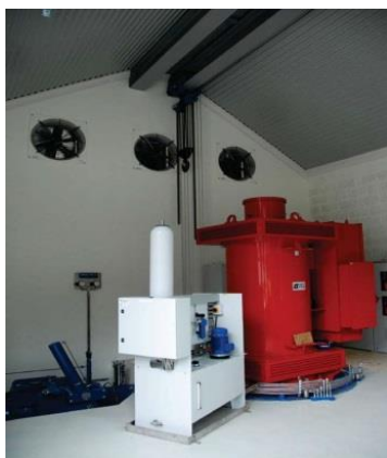
写真-6 発電機 (奥) および油圧装置 (手前)
