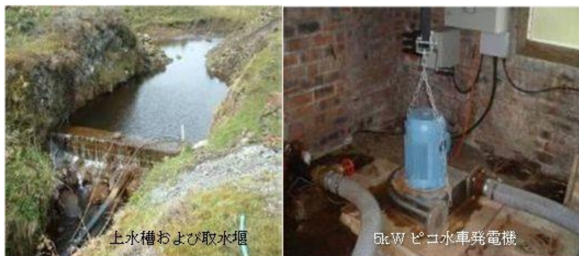
写真-5 ピコ発電設
