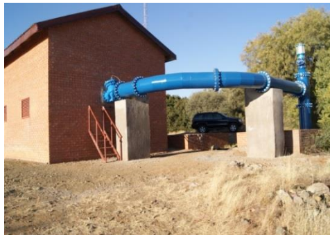
写真-1 水圧管・発電所建屋
