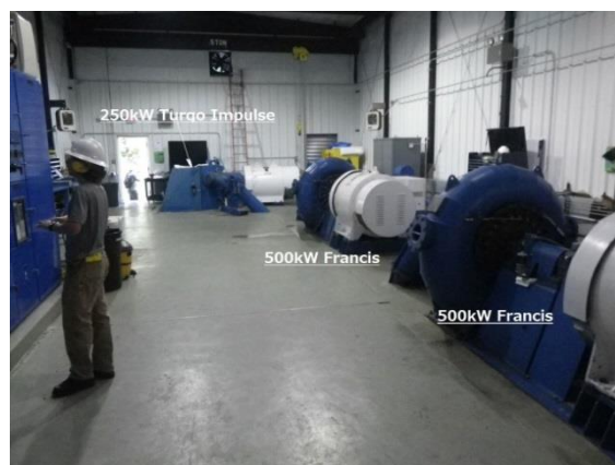
Humpback Creek 発電所内の 水車発電機
