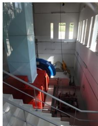
写真-2 発電所内部
