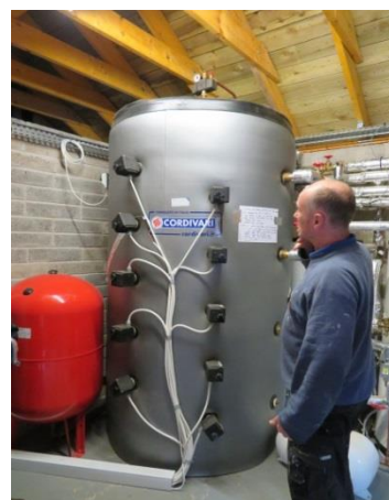
写真-5 給湯用電気ボイラ
