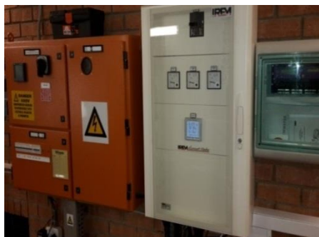
写真-3 発電機制御盤
