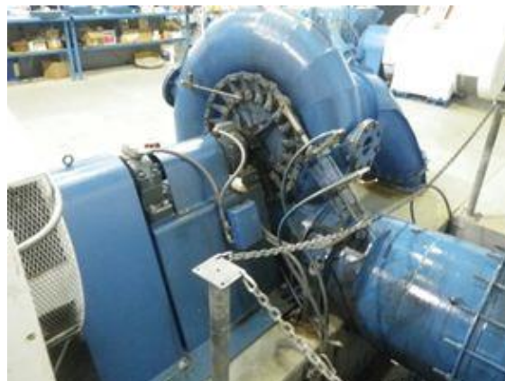
写真-2 500kW フランシス水車発電機
