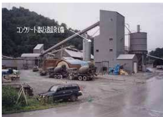
写真－3 建屋内に収納された コンクリート製造設備 (奥只見放水口仮設備用地内)
