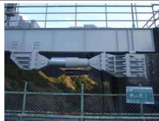
高減衰ダンパー設置部
