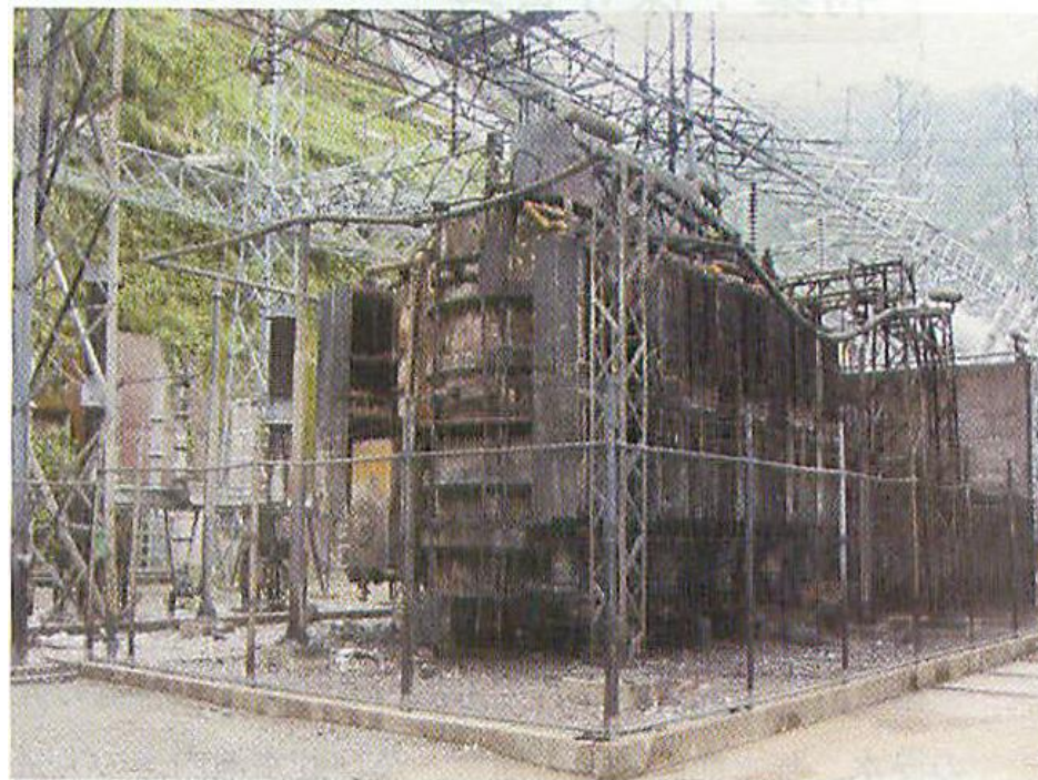
上椎葉発電所 変圧器損傷状況
