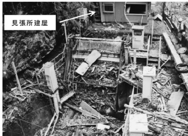
湯山発電所大間川えん堤被災状況
