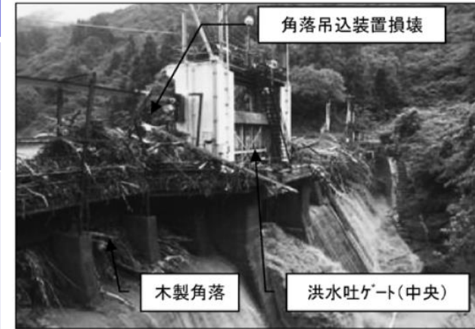
湯之谷発電所えん提被災状況
