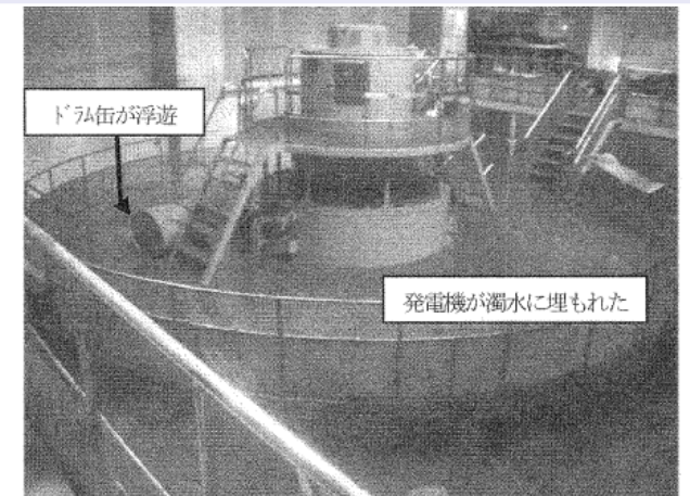
新猪谷発電所発電所本館被災状況
