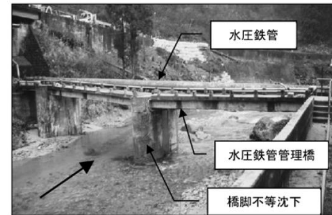
永松発電所水圧鉄管管理橋被災状況
