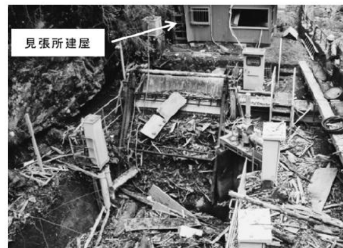
湯山発電所大間川えん堤被災状況
