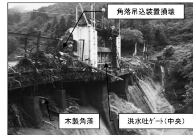
湯之谷発電所えん提被災状況
