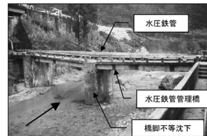
永松発電所水圧鉄管管理橋被災状況
