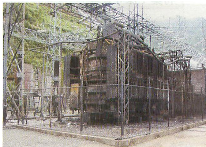
上椎葉発電所 変圧器損傷状況
