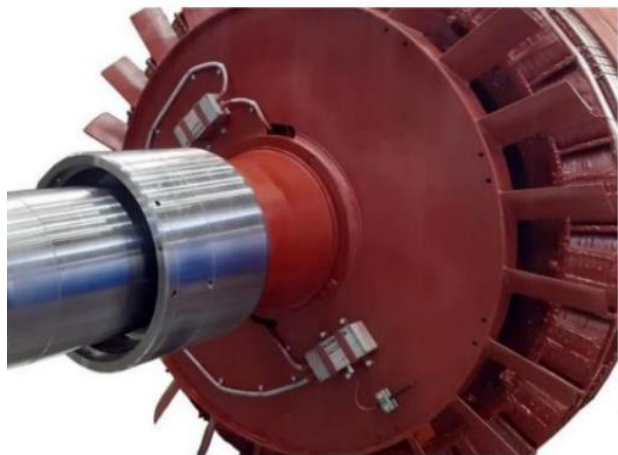
回転子巻線の温度測定用の無線監視装置取付写真
